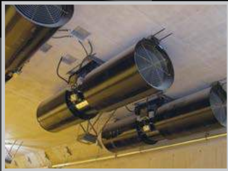
JET FAN THRUST TESTING
