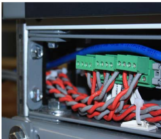
Figure 43 : Ouverture latérale pour le câble Ethernet
