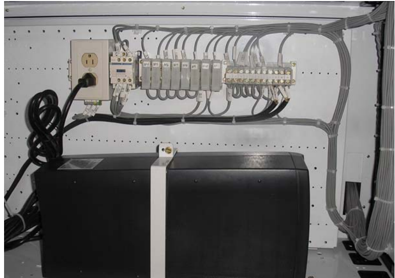
Figure 14 : Ensemble de l'UPS
