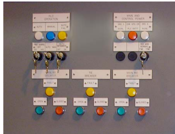
Figure 1 : Automate installé sur un panneau de commutation QED Power-Style®
