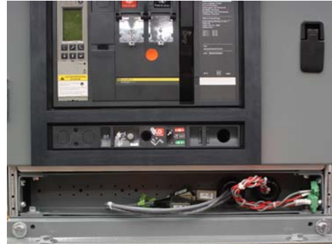
Figura 35: Ejemplo de cables de comunicación temporalmente almacenados en el ducto para cables para su envío
