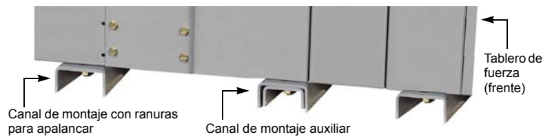
Figura 7: Posición final del tablero de fuerza (vista lateral)
