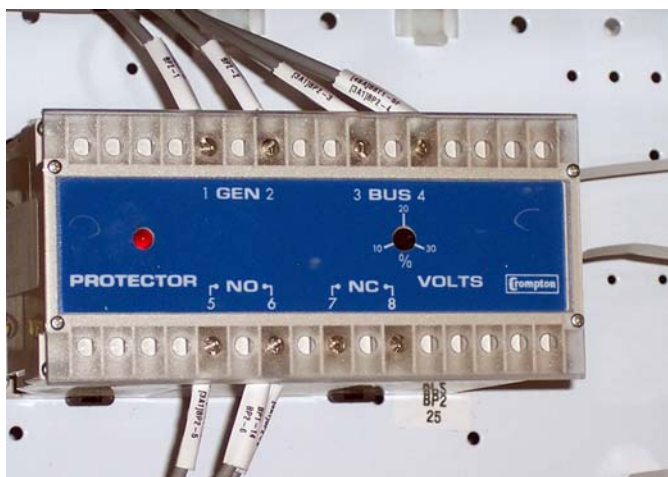
Figure 13 : Ensemble de relais de vérification de la synchronisation
