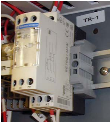
Figure 20 : Relais de démarrage de la génératrice
