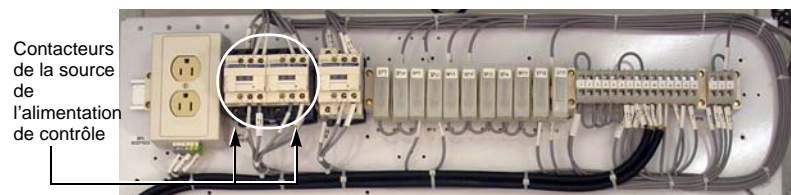
Figure 15 : Contacteur de la source de l'alimentation de contrôle
