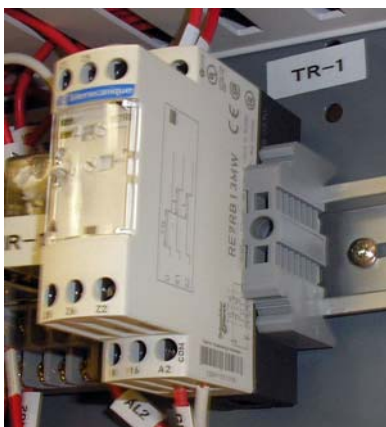
Figura 20: Relevador de arranque del generador
