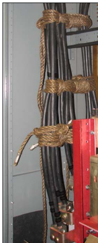
Figure 24 – Exemple de l'entrave de câble
