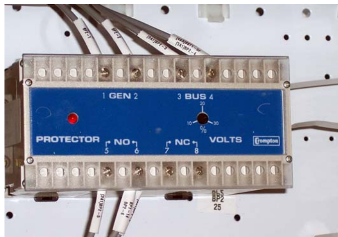
Figura 13: Ensamble de relevador de comprobación de sincronización
