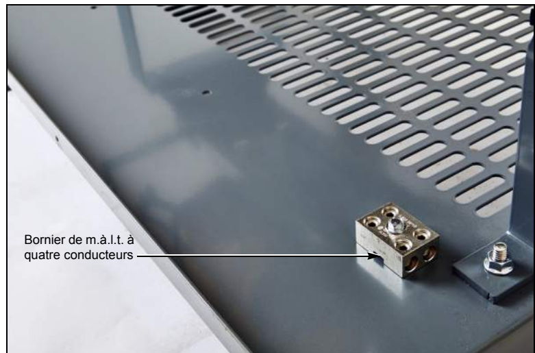
Figure 24 : Bornier de m.à.l.t. à quatre conducteurs
