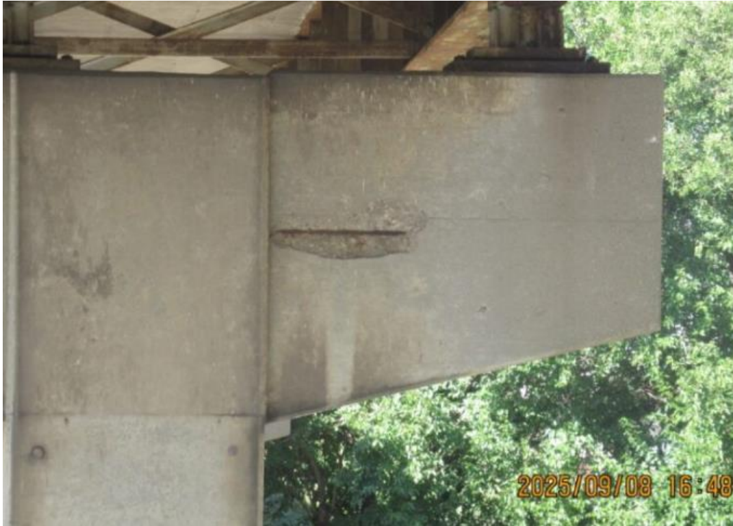
Photo 17: 1'H x 2'W x 2" deep spall (Pier Cap 21A)
