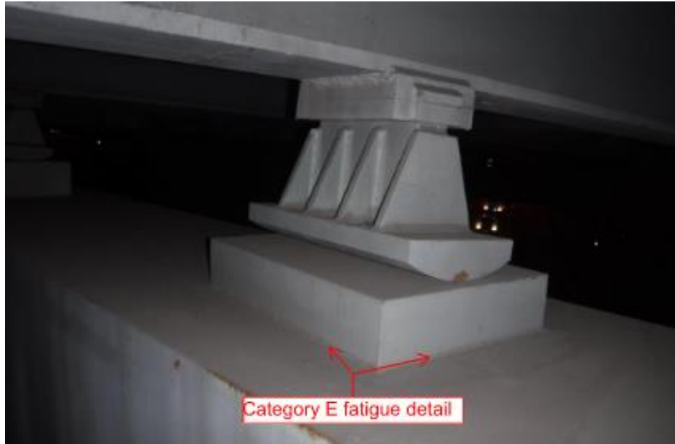
Photo 35: Fatigue detail (Pier 25J)
