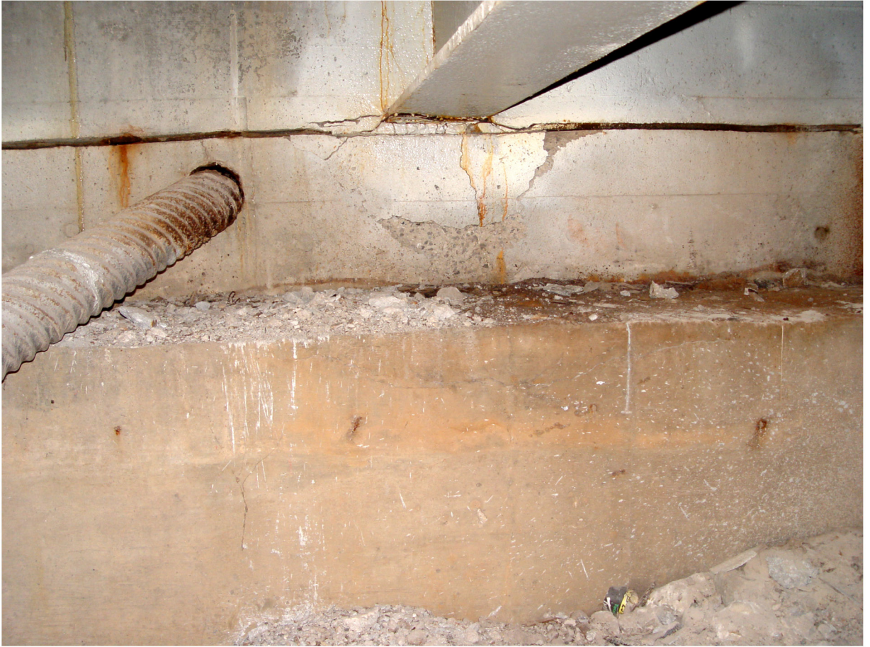
1808745 11_7_05 P5 start abut delamination & spall.jpg
