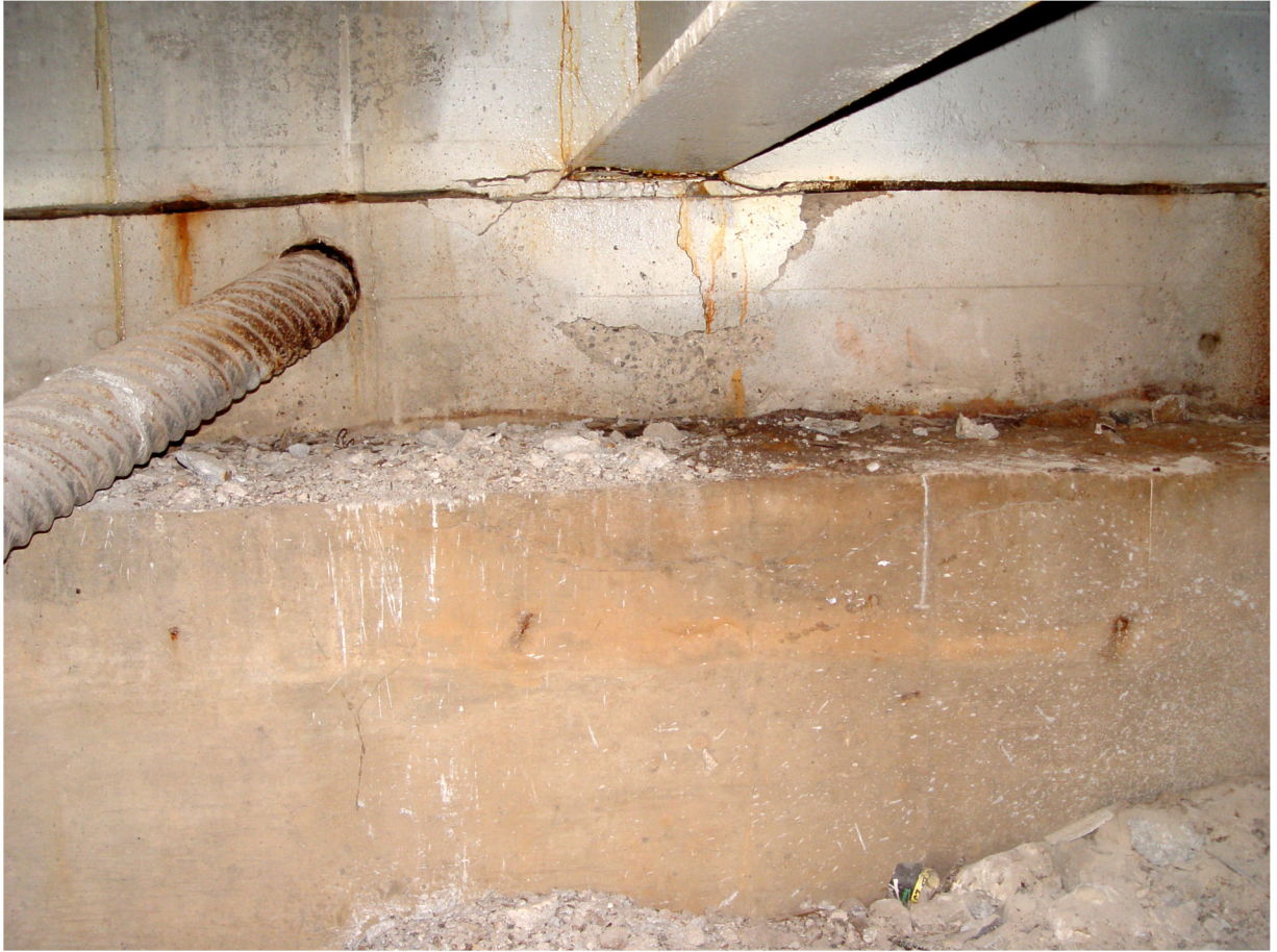
1808745 11_7_05 P5 start abut delamination & spall.jpg
