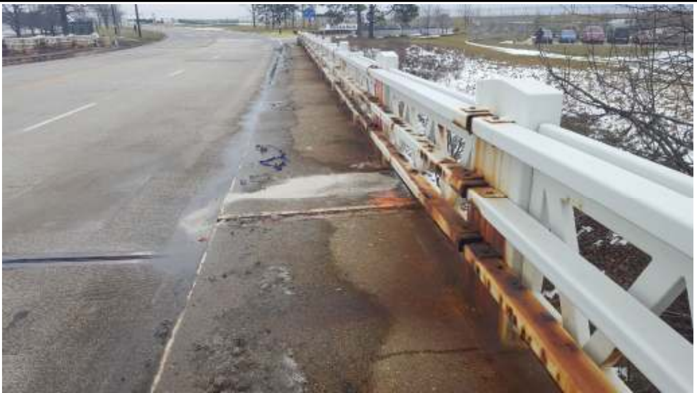
Pavement Photo C-7
