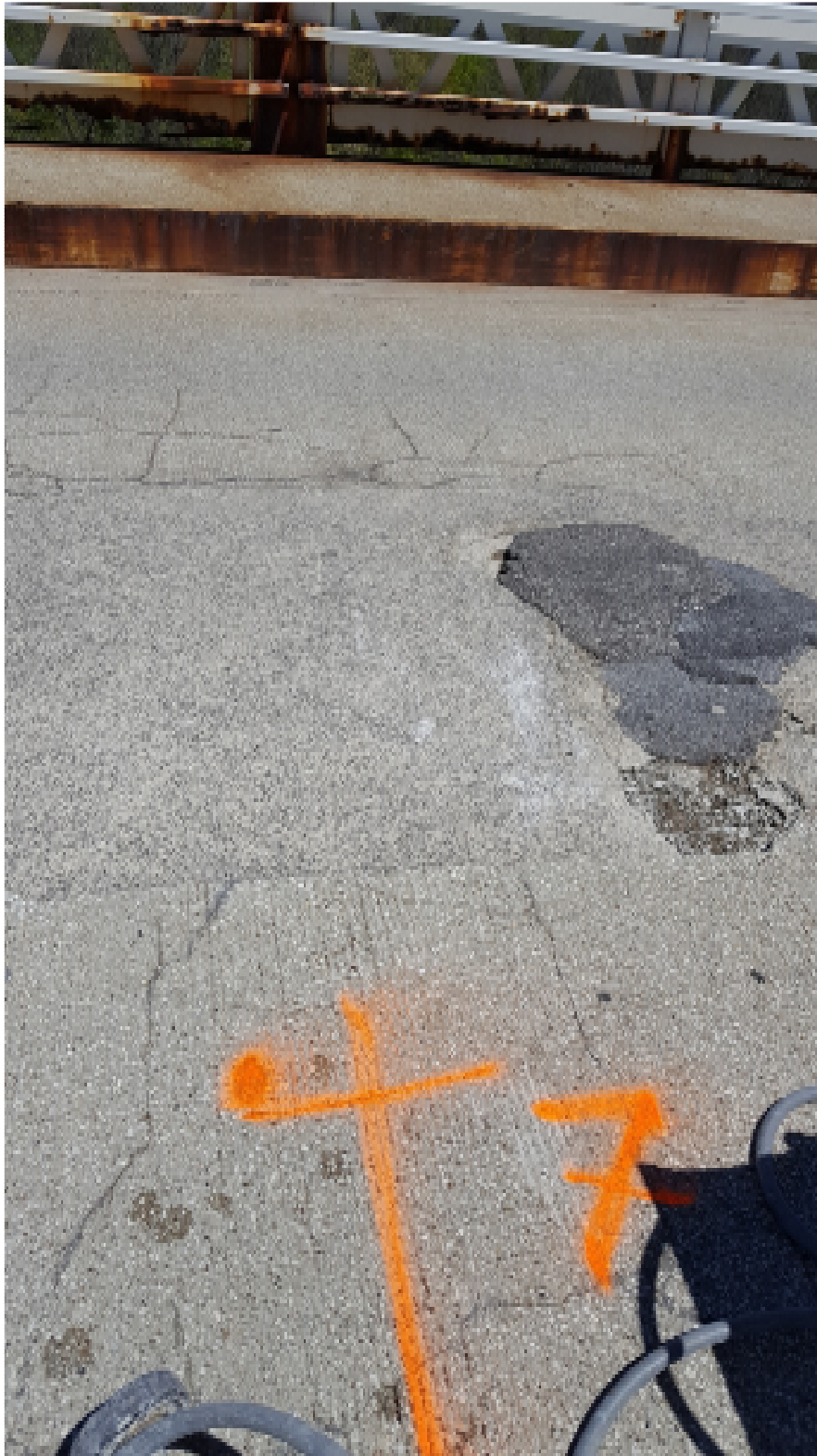
Pavement Photo C-7
