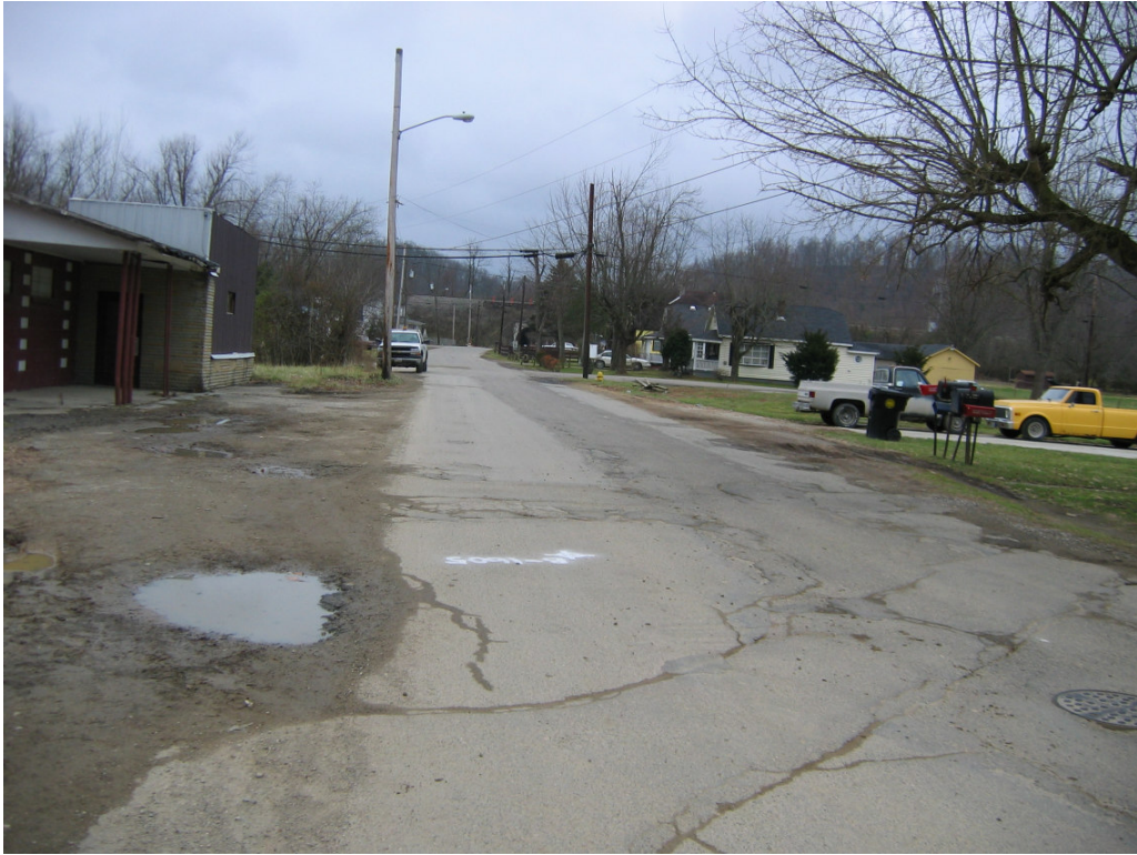
Photo 3. Slocum Avenue asphalt pavement.
